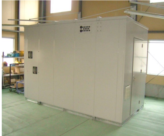
携帯基地局、パワールーム
